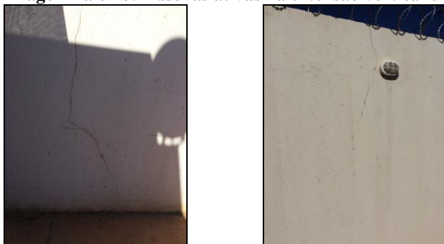
Imagem 1a e 1b: Fissuras ativas na extensão vertical do muro
